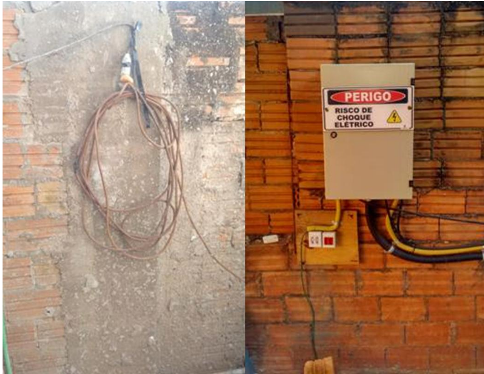
Figura 9: Detalhe da instalação elétrica na obra Fonte: O autor (2018)
