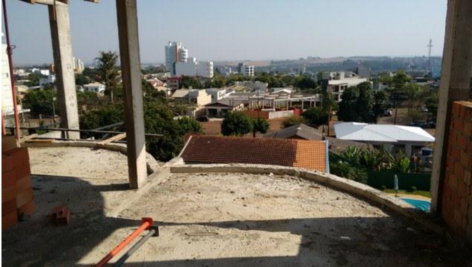
Figura 5: Detalhe da falta de guarda corpo na periferia da obra Fonte: O autor (2018)
