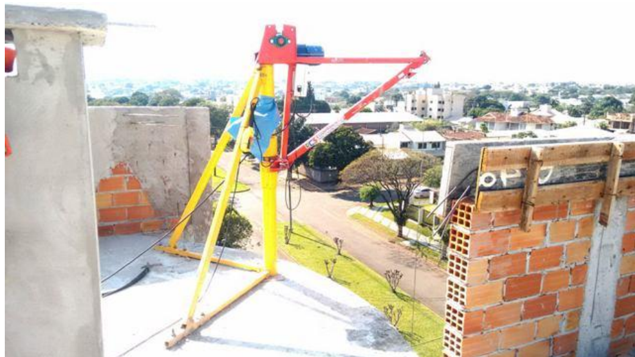
Figura 6: Detalhe da falta de guarda corpo próximo a mini grua Fonte: O autor (2018)
