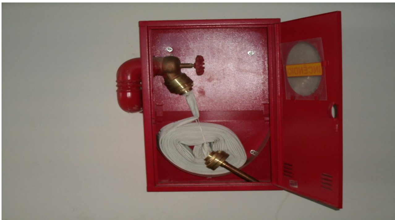
Figura 16: Mangueira de incêndio corretamente instalada.
