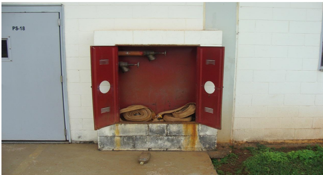
Figura 10: Mangueras de Incêndio na Parte Externa da Unidade Penal.
