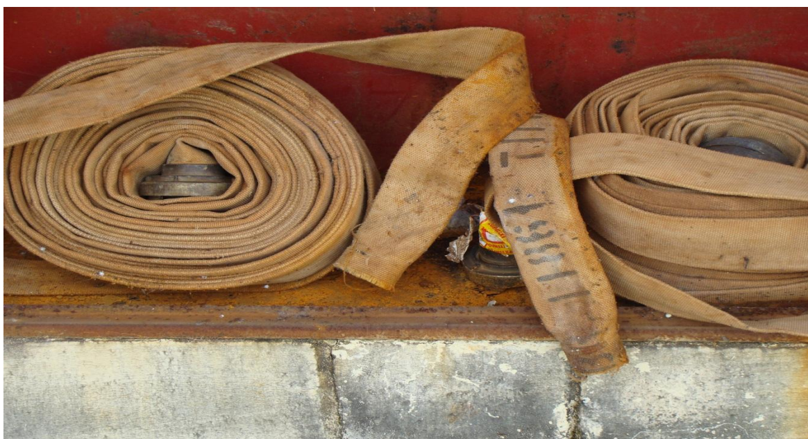
Figura 09: Mangueiras de Incêndio fora das condições mínimas de uso.
