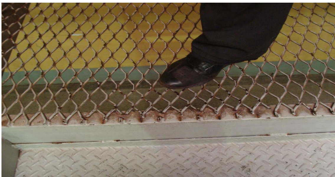
Figura 14: Grades em estado de oxidação.
