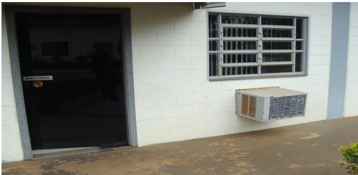
Figura 13: Local inadequado de equipamento de refrigeração.
