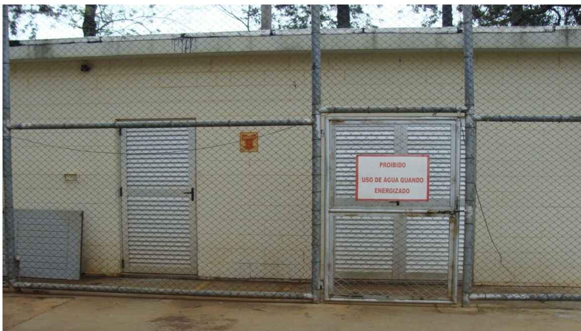
Figura 04: Abrigo do gerador.
