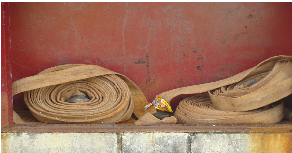
Figura 08: Mangueiras de incêndio desconectadas e fora das condições mínimas de uso.
