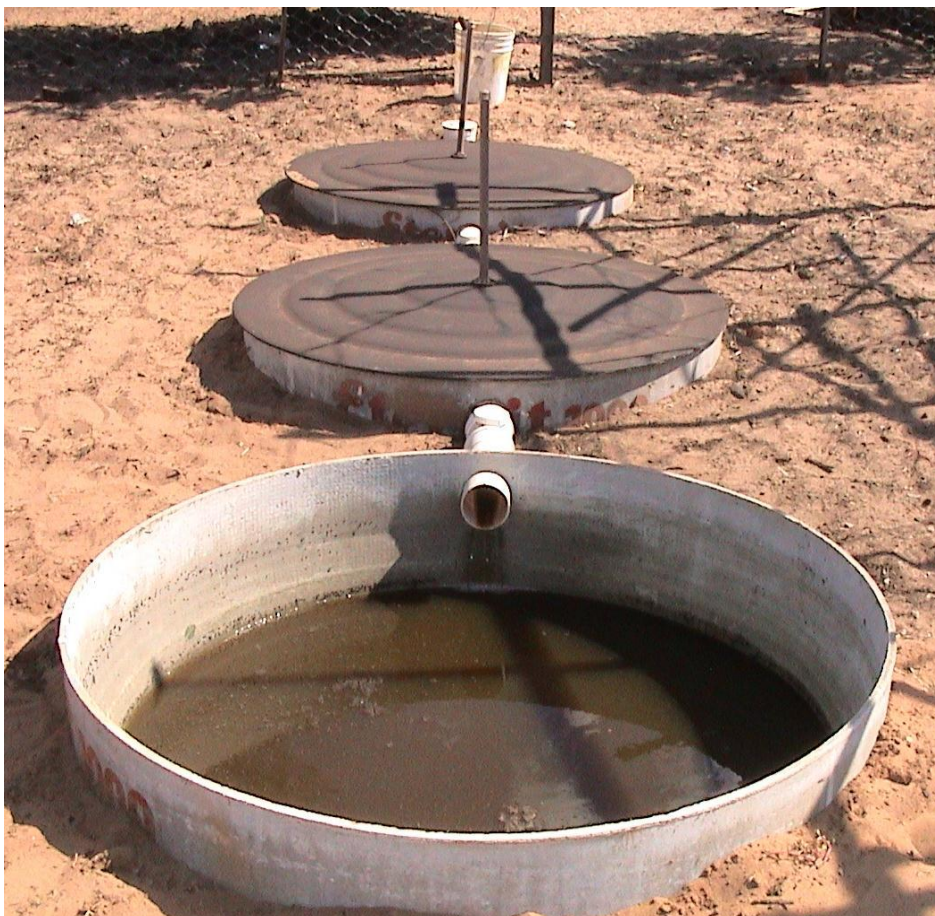
Figura 1 – Fossa séptica biodigestor
