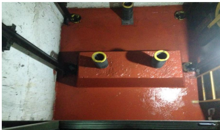
Figura 11: Poço do elevador, sistema de para-choques de molas.
