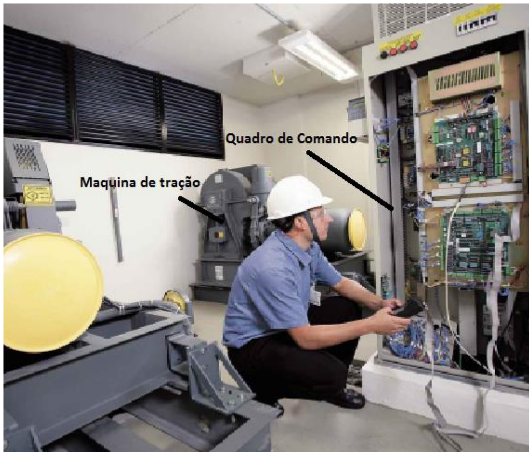
Figura 3: Casa das máquinas Fonte: Thyssenkrupp Elevadores
