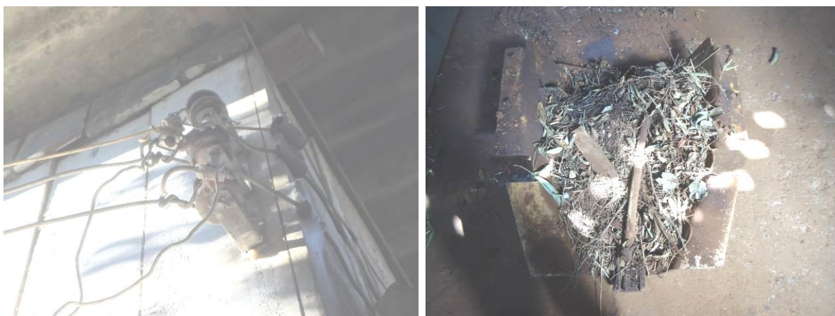
Figura 50 - Conexão direta improvisada na rede para obtenção de tensão e corrente necessária para o funcionamento da fonte, risco elétrico (esquerda); Resíduos florestais depositados na proteção do motor acumulados em serviços de enleiramento ou limpeza de lavoura, risco de incêndio (direita). Fonte: Acervo do autor.
