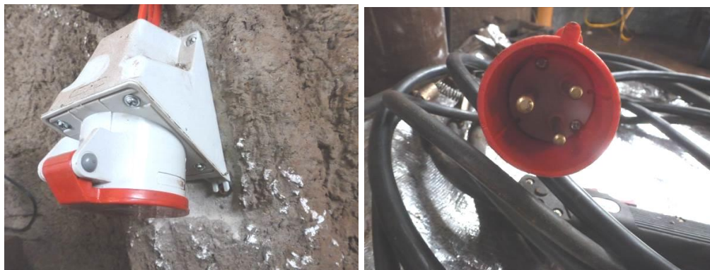
Figura 46 – Conexão a rede elétrica trifásica (esquerda) e detalhe dos pinos de conexão do cabo de ligação (direita).
