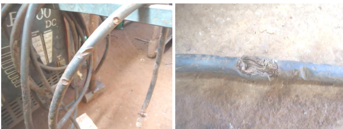
Figura 45 – Cabos de ligação com destaque na avaria do isolamento (esquerda); Zoom do cabo de retorno com condutor de cobre exposto (direita). Fonte: acervo do autor.
