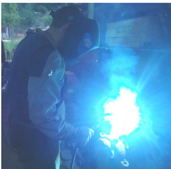
Figura 29 – Radiação gerada pelo arco elétrico (luz visível). Fonte: Acervo do autor.
