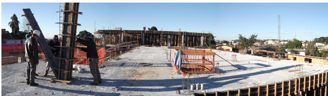
Figura 10 - Proteções em shaft's na laje
