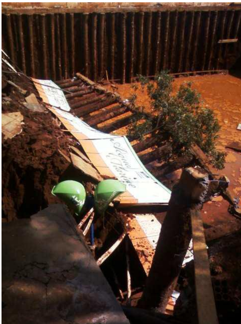
Figura 1: Colapso de cortina de estacas na cidade de Maringá-PR Fonte: Souza e Enami, Revista Tecnológica (UEM), Maringá, v. 18, p. 91-101, 2009.
