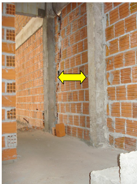
Figura 7. Incompatibilidade redução na circulação (Verificado in loco)
