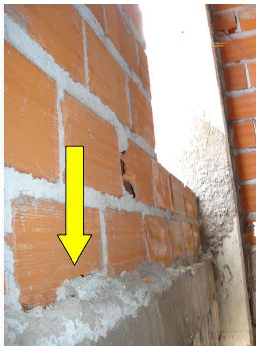
Figura 10. Saliência das vigas em relação à alvenaria
