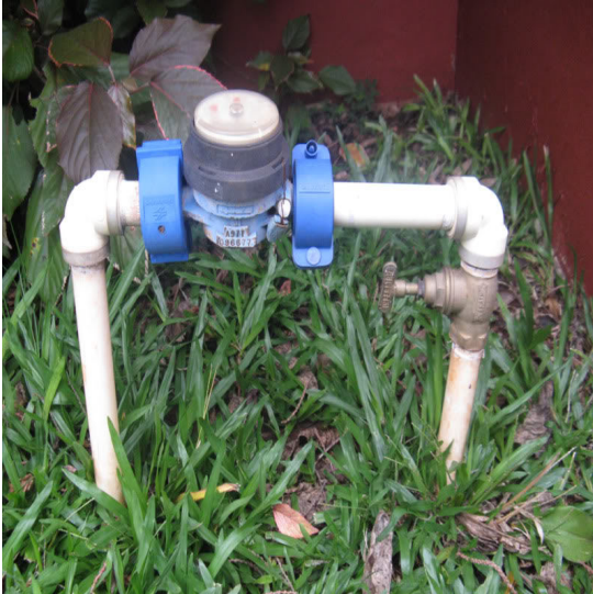
Figura 3: Medidor de água da Sanepar. Fonte: Foto tirada em uma residência.
