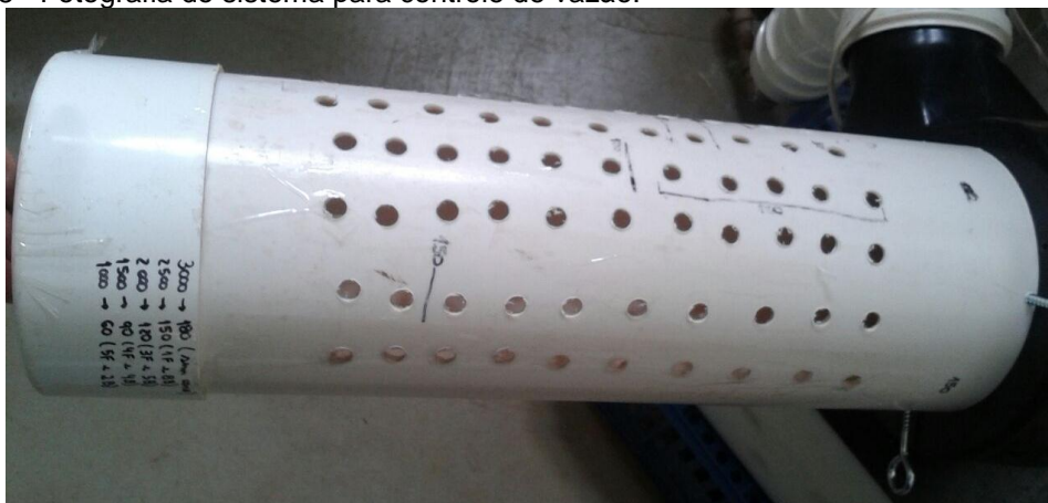
Figura 8 - Fotografia do sistema para controle de vazão.
