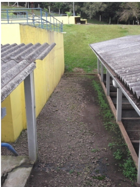
Figura 11: Lodo depositado no chão.
