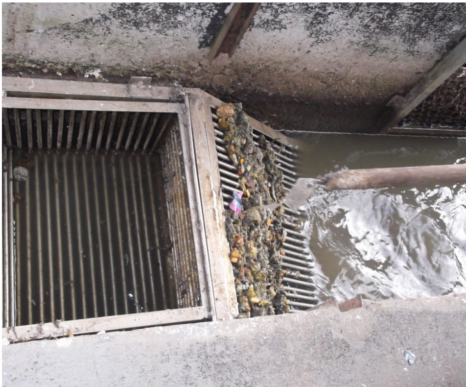
Foto 05. Detalhe do acúmulo de sujeira no Gradeamento.
