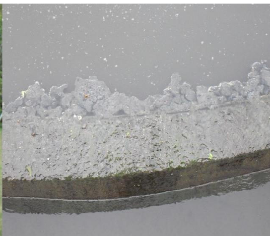
Figura 13: Sólidos em Suspensão no Decantador.
