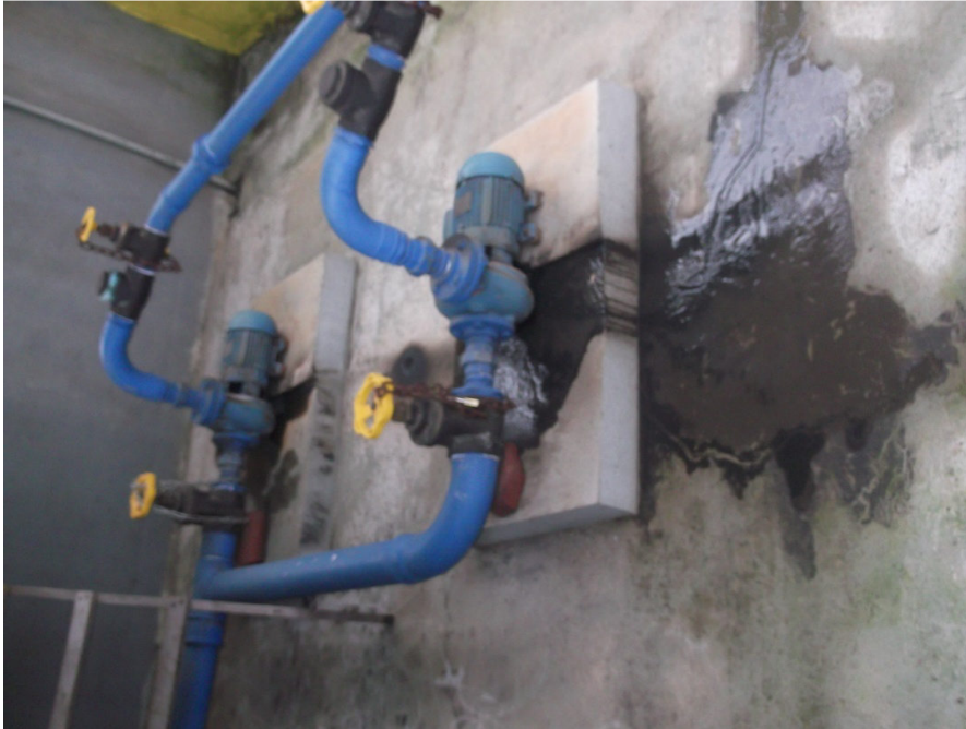
Figura 22: Vazamento de Esgoto.
