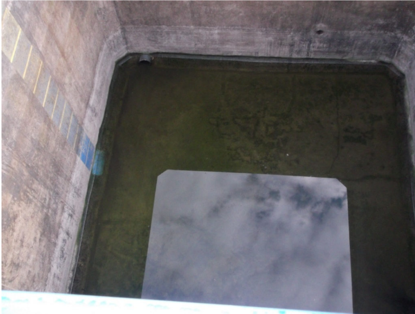
Figura 15: Caixa de Adensamento.
