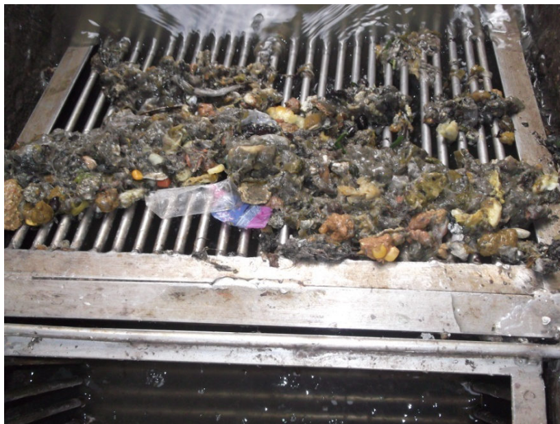
Foto 04. Acúmulo de sujeira no Gradeamento.
