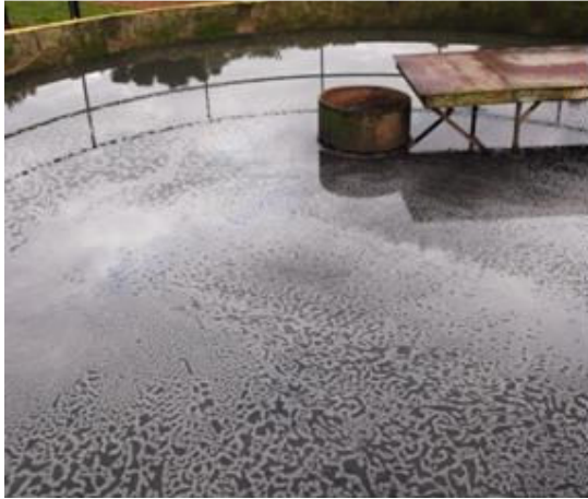
Figura 14: Cano central do decantador.
