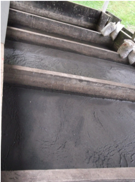
Figura 17: Leitos de secagem.
