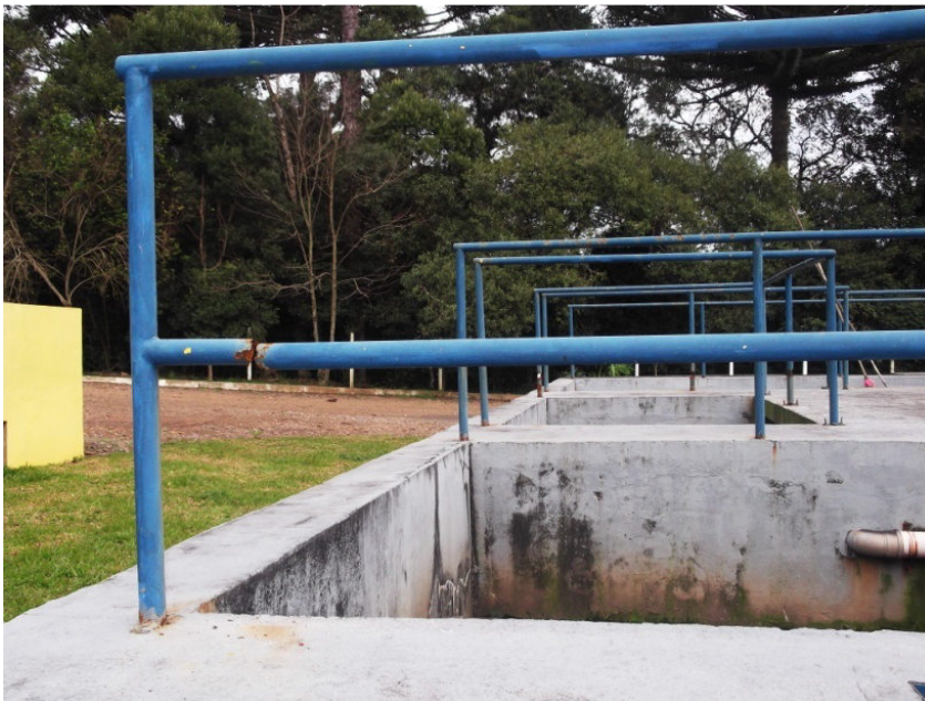
Foto 09: Corrimão danificado. Fonte: Kathine Tessmann Soligo (2015).
