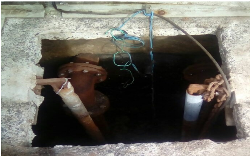
Figura 05 – Conjunto de Bombas Submersíveis da E.E.E. Fonte: Autora (2018)
