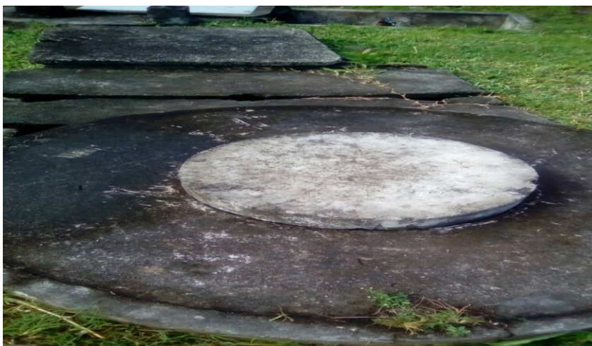
Figura 04 – Caixa de Desarenação ou (caixa de areia). Fonte: Autora (2018)
