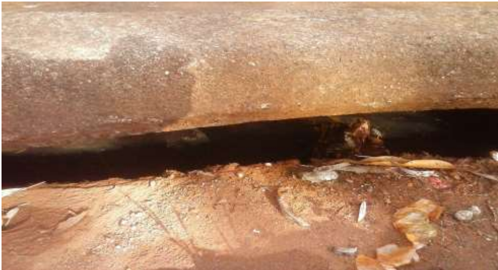
Imagem 5: Bueiro entupido com presença de água e consequentemente larvas de mosquito.
