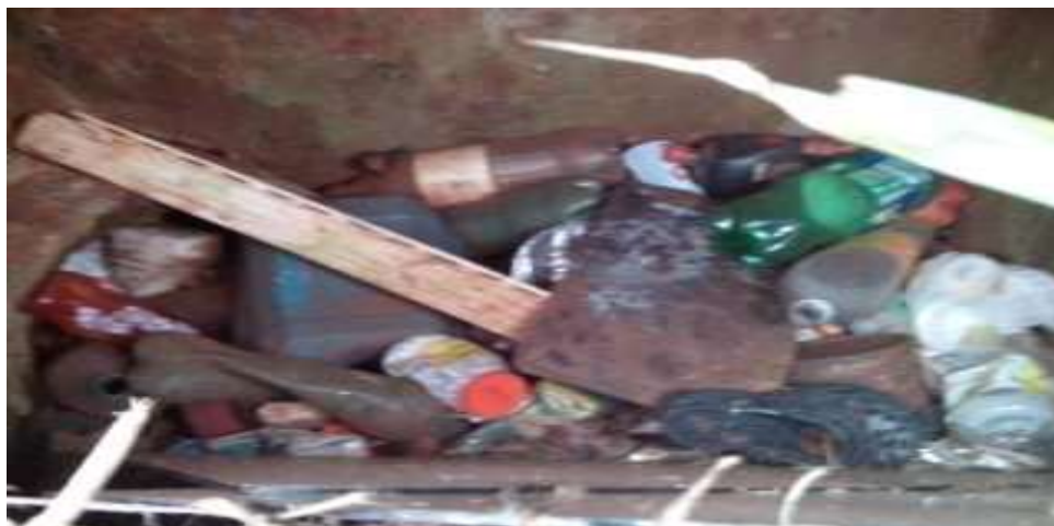
Imagem 7: Bueiro com grande presença de resíduos sólidos. Fonte: Liliâne H. Zanon
