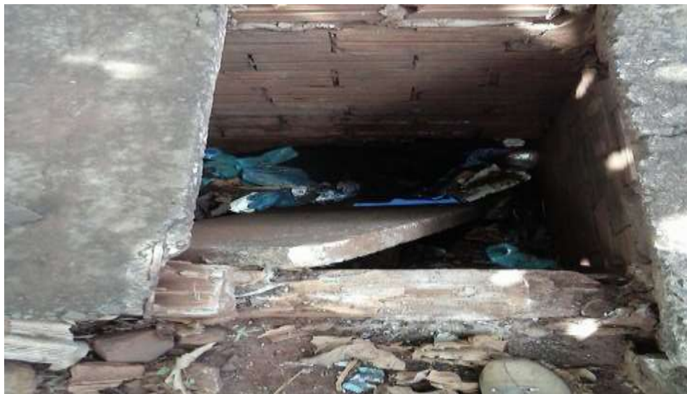
Imagem 6: Bueiro com estrutura comprometida e presença de resíduos sólidos.
