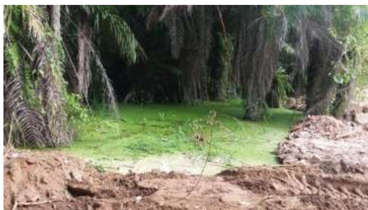
Figura 11 – Aterramento de uma lagoa localizada na Praça da Coruja Fonte: Amom Loteamento Miragem (2018)
