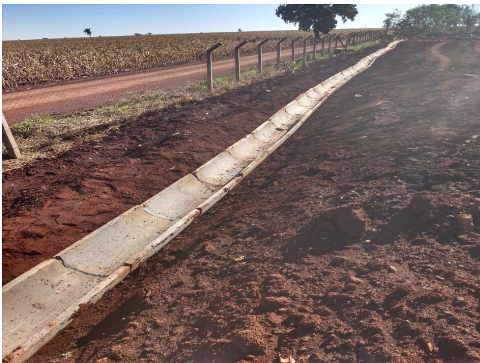
Figura 17 – Canaletas para drenagem das águas pluviais
