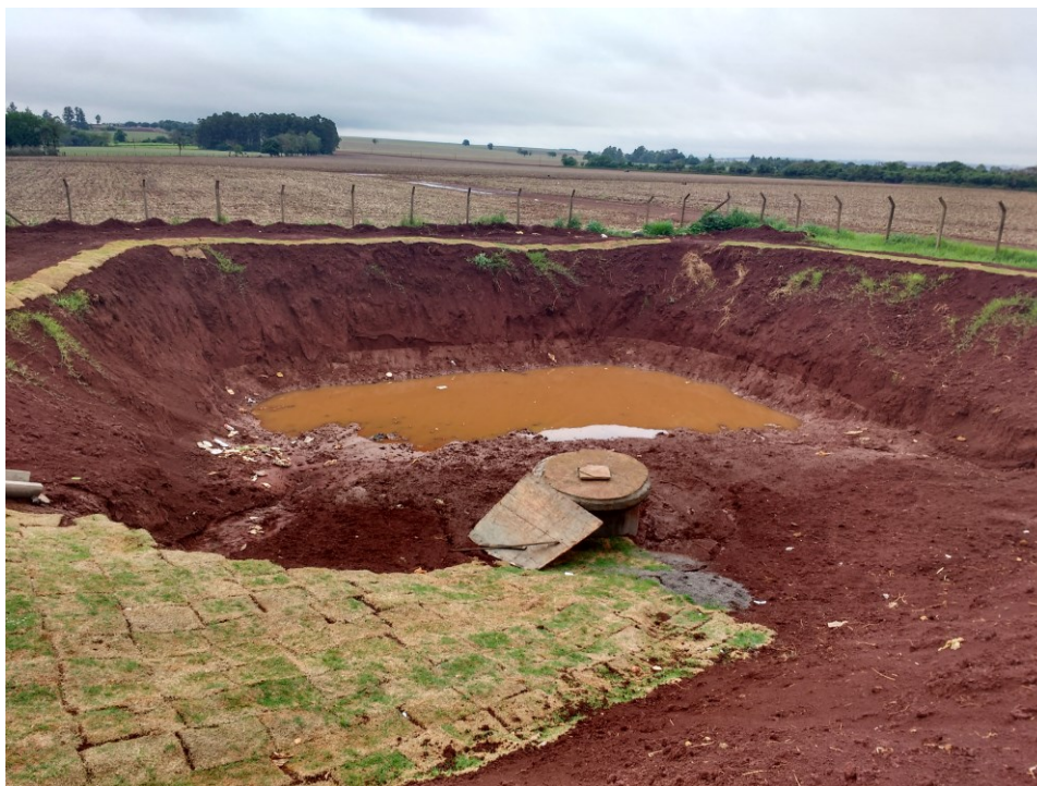
Figura 18 – Lagoa para contenção das águas pluviais
