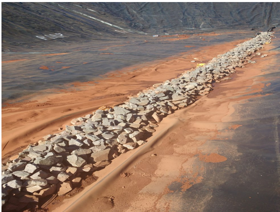
Figura 19 – Estrutura necessária para a drenagem do Chorume
