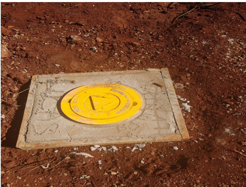
Figura 21 – Poço para monitoramento das águas subterrâneas Fonte: Município de Peabiru (2018)
