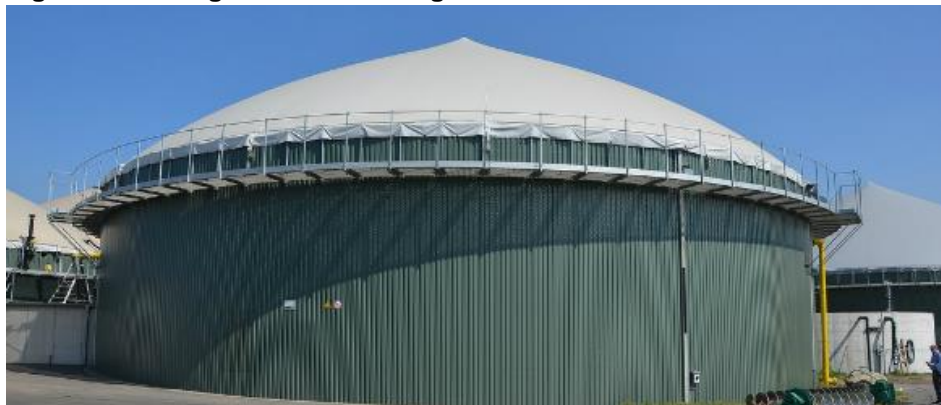
Figura 9 – Biodigestor de tecnologia Alemã
