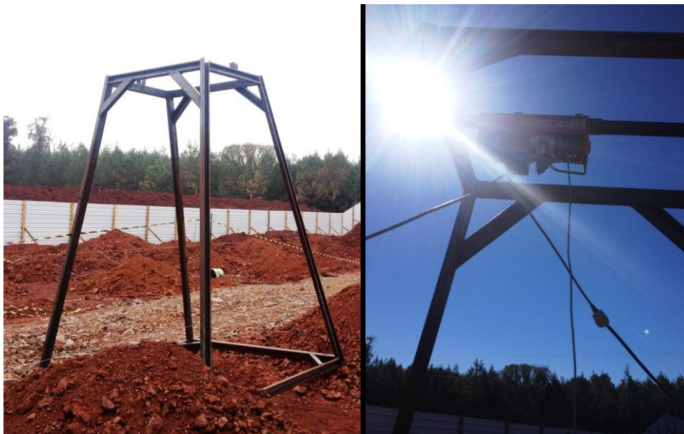
Foto 21 e Foto 22 - Talha elétrica.
