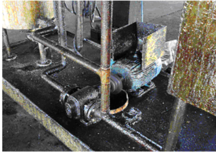
Fotografia 2 – Bomba e motor elétrico do setor de filtragem Fonte: Elaborado pelo autor
