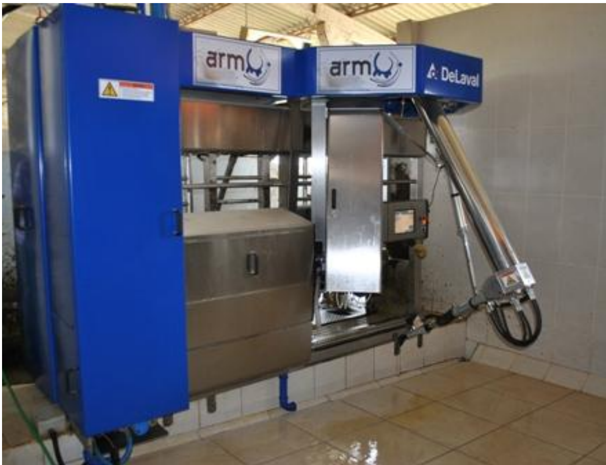
Figura 1 – Estação de ordenha voluntária VMS – DeLaval
