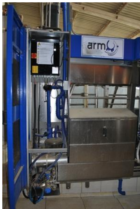
Figura 6- Porta aberta com o quadro elétrico do equipamento Fonte: Autoria Própria
