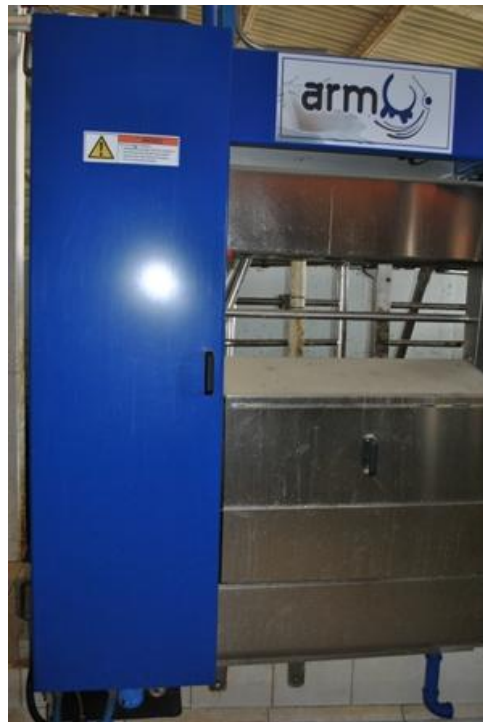
Figura 5 - Porta de acesso ao quadro elétrico Fonte: Autoria Própria
