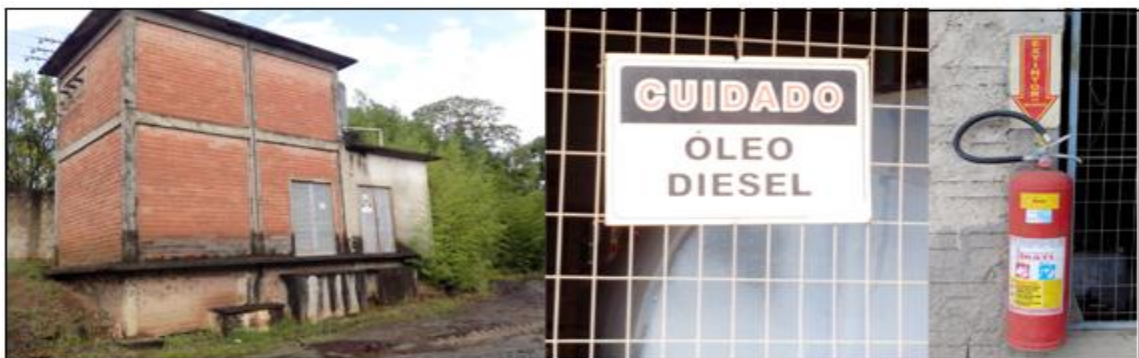
Fotografia 3 – Sinalização de proibição, alerta e equipamentos de combate a incêndio.
