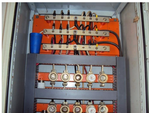
Figura 3: Quadro de energia com copo.
