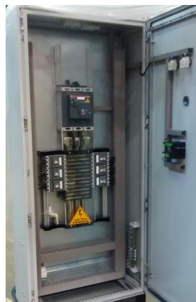
Figura 7: Painel de comando.
