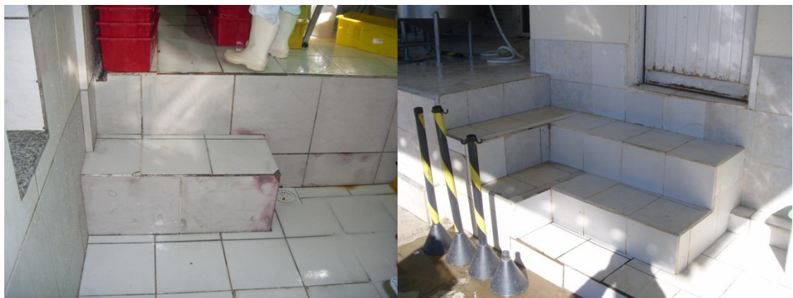
Figura 16 – Degraus nas vias de circulação e na saída da área de produção Fonte: A autora (2013)
