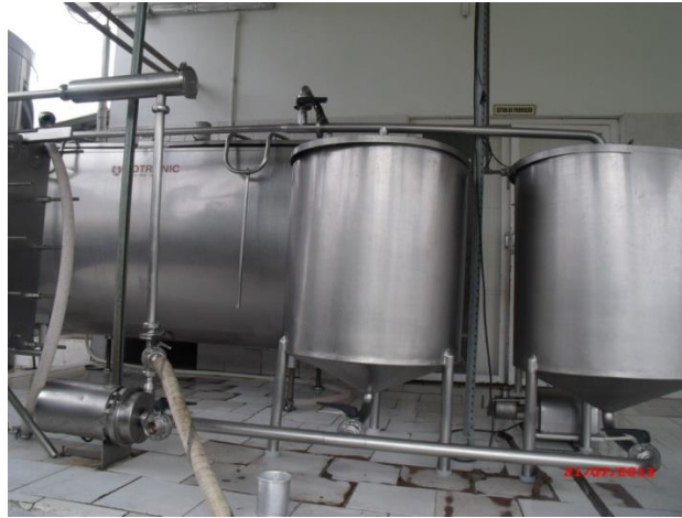
Figura 4 – Tanque de refrigeração Fonte: A autora (2013)
