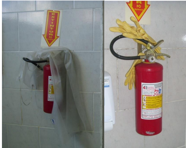
Figura 17 - Obstrução dos extintores Fonte: A autora (2013)
