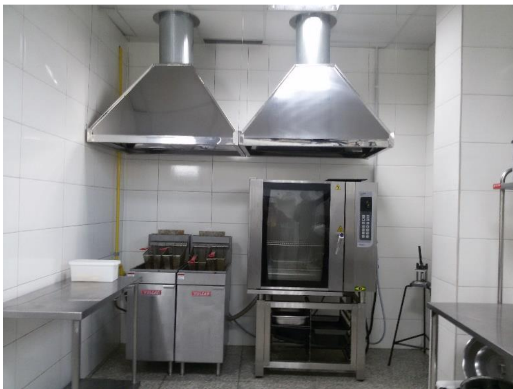
Figura 5 – Fotografia das fritadeiras e forno, bem como de suas coifas, presentes na cozinha industrial analisada Fonte: Autoria própria (2017)
