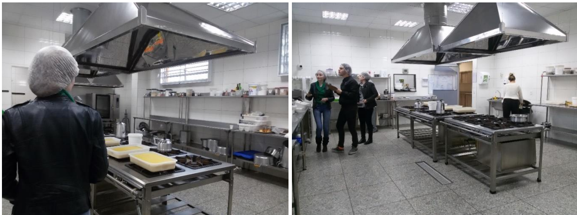
Figura 2 – Disposição dos equipamentos na cozinha analisada no presente trabalho Fonte: Autoria própria (2017)
