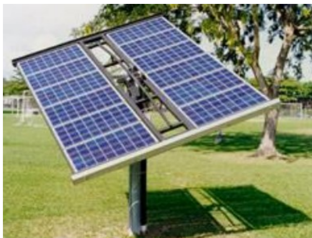
Figura 1 - Painel Solar com sistema de rastreamento solar
