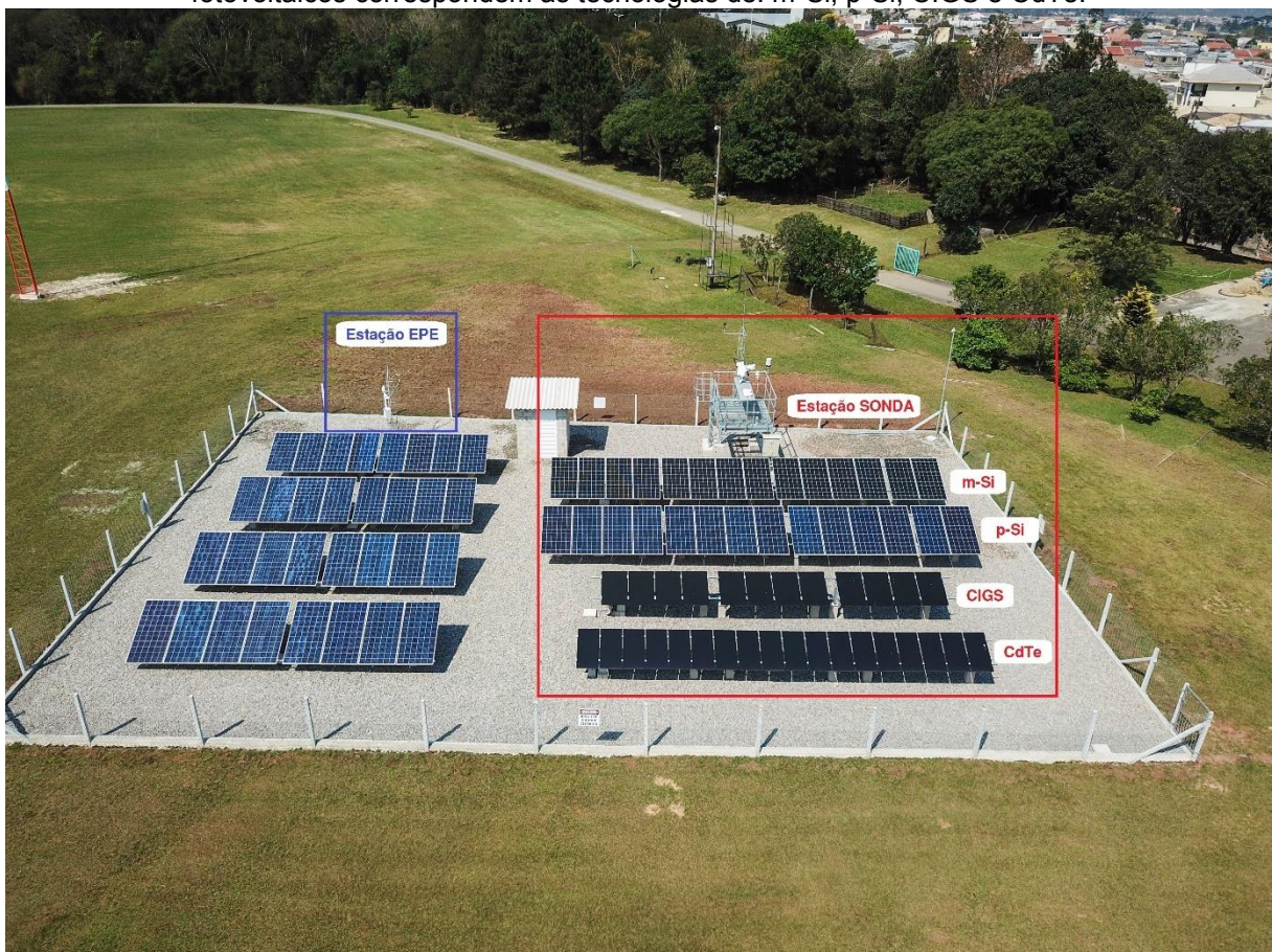
Figura 20 - SFVCR e estações solarimétricas da EPESOL Curitiba. As quatro fileiras de painéis fotovoltaicos correspondem às tecnologias de: m-Si, p-Si, CIGS e CdTe.
