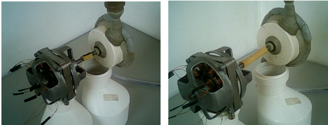
Figura 31 – Ligação entre gerador e turbina com conexão flexível.
