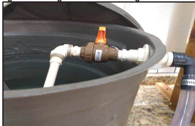
Figura 16 – Registro de saída da água do sistema
