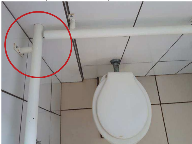
Figura 30 – Barras de apoio horizontais, ESF São Francisco, Toledo – PR.
