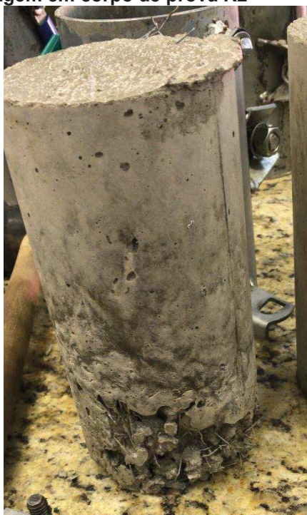
Figura 26 - Nichos de concretagem em corpo de prova R2
