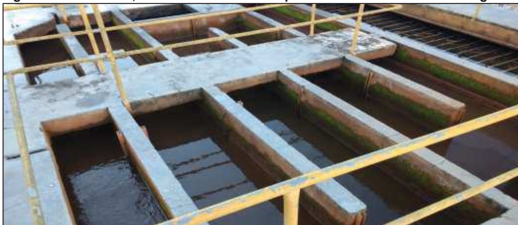
Figura 11 – Chicanas, estruturas de concreto para diminuir a velocidade da água
