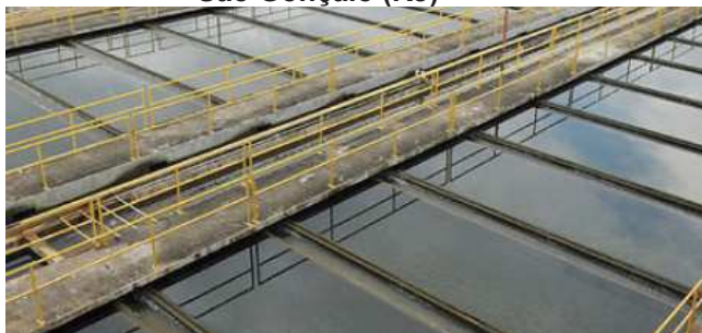
Figura 2 – Decantadores da ETA Água de Laranjal - São Gonçalo (RJ)
