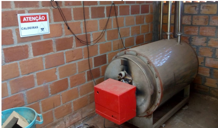
Figura 6 - Placa instalada próximo a Caldeira
