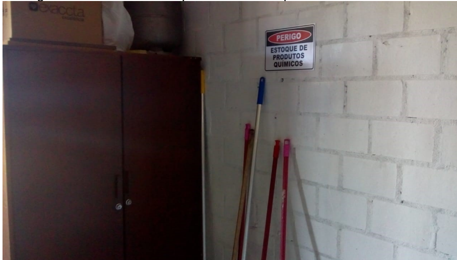
Figura 5 - Placa instalada próximo ao Estoque de Produtos Químicos
