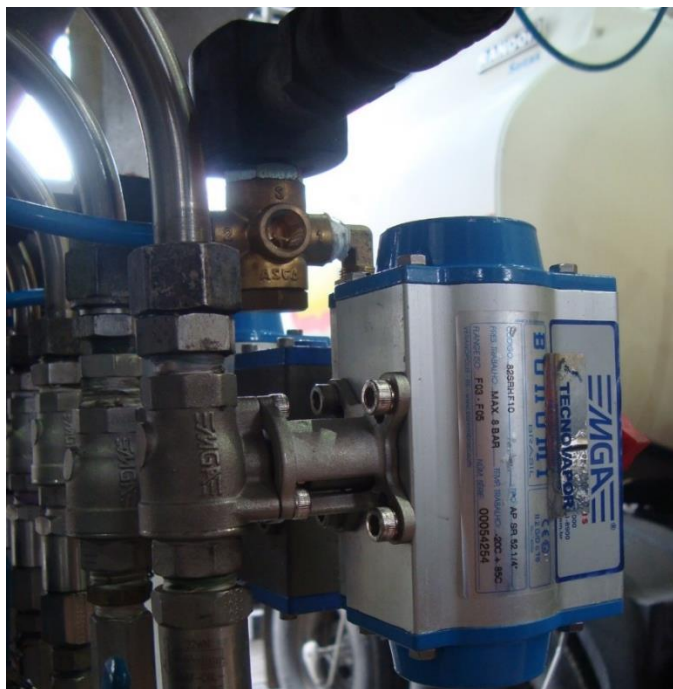
Fotografia 11 - Posicionamento válvula solenoide
