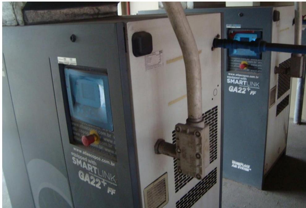
Fotografia 5 - Compressores da instalação
