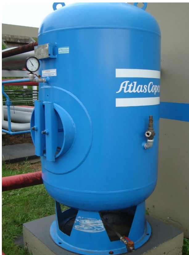
Fotografia 6 - Reservatório de ar comprimido
