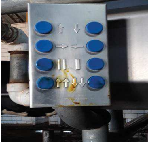
Figura 7 – Quadro de comando de movimentação do Portão
