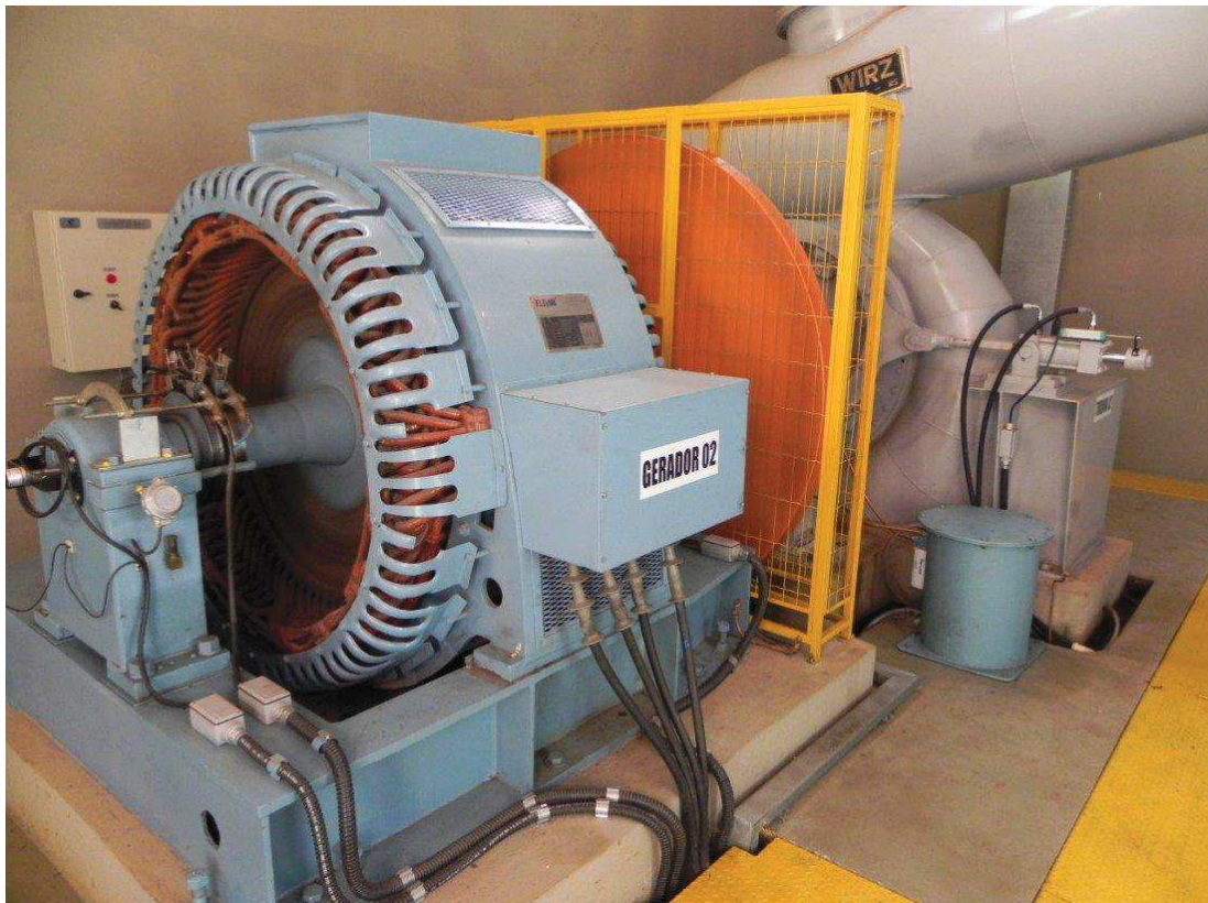
Figura 19 - Grupo gerador PCH Baitaca
