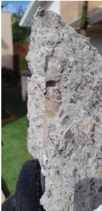
Figura 55 – Deslocamento da barra em relação ao concreto e falha no comprimento de ancoragem
