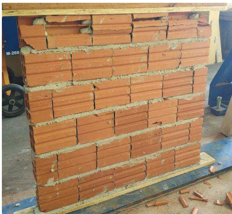
Figura 13 - Fissuração típica protótipo com argamassa convencional na horizontal e na vertical
