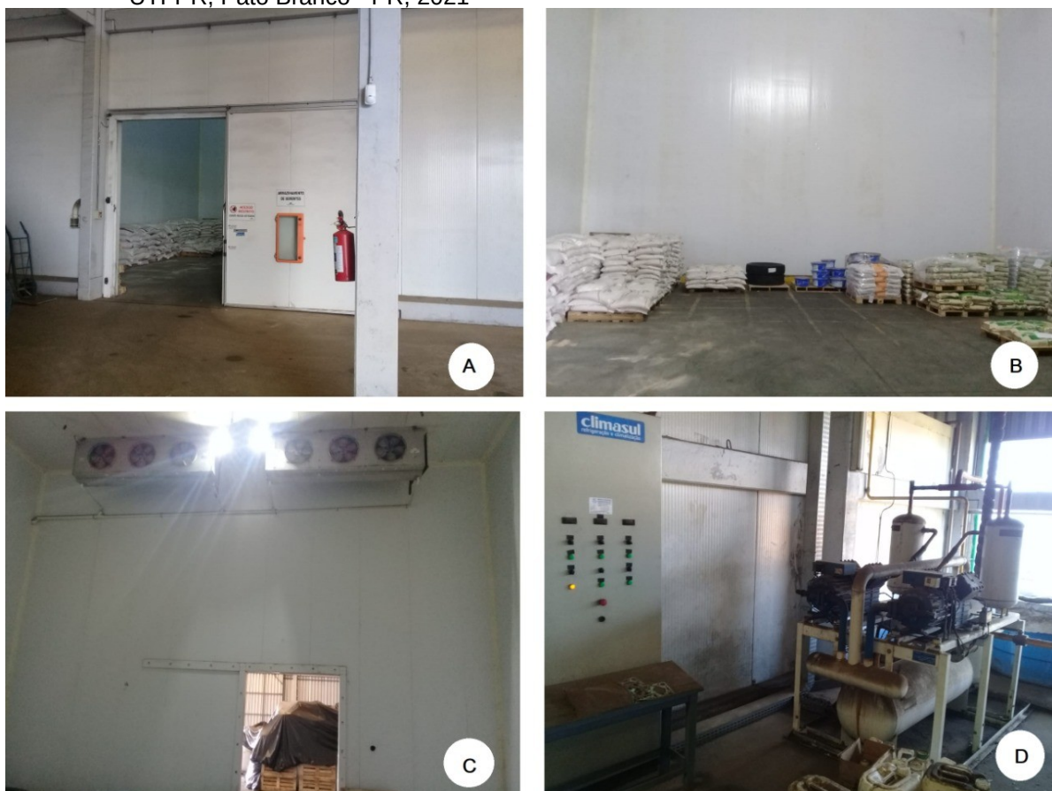
Figura 1 – Estrutura do ambiente de armazenamento com controle de temperatura e umidade. UTFPR, Pato Branco - PR, 2021
