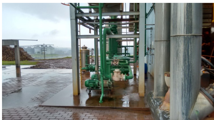
Figura 27: Localização das bombas da caldeira de estudo 2
