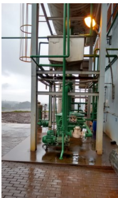
Figura 26. Localização das bombas da caldeira de estudo 1
