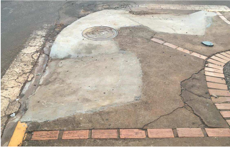
Figura 13 - Faixa de acesso inadequada
