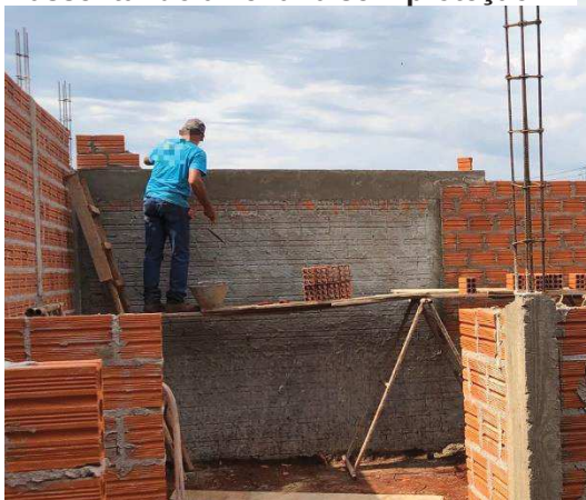
Figura 54 – Funcionário assentando alvenaria sem proteção.
