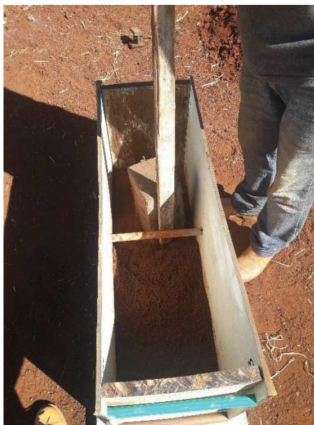
Figura 32 – Compactação do solo.
