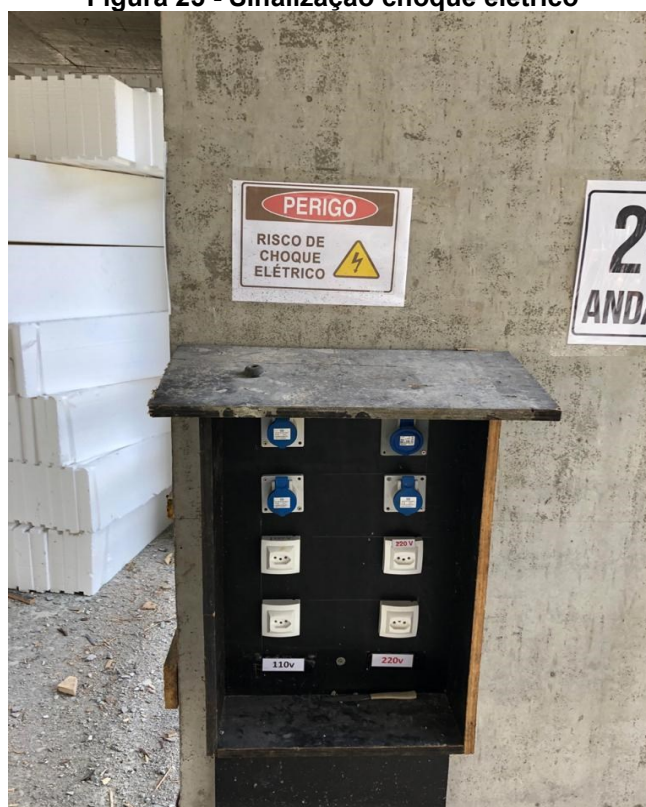
Figura 25 - Sinalização choque elétrico
