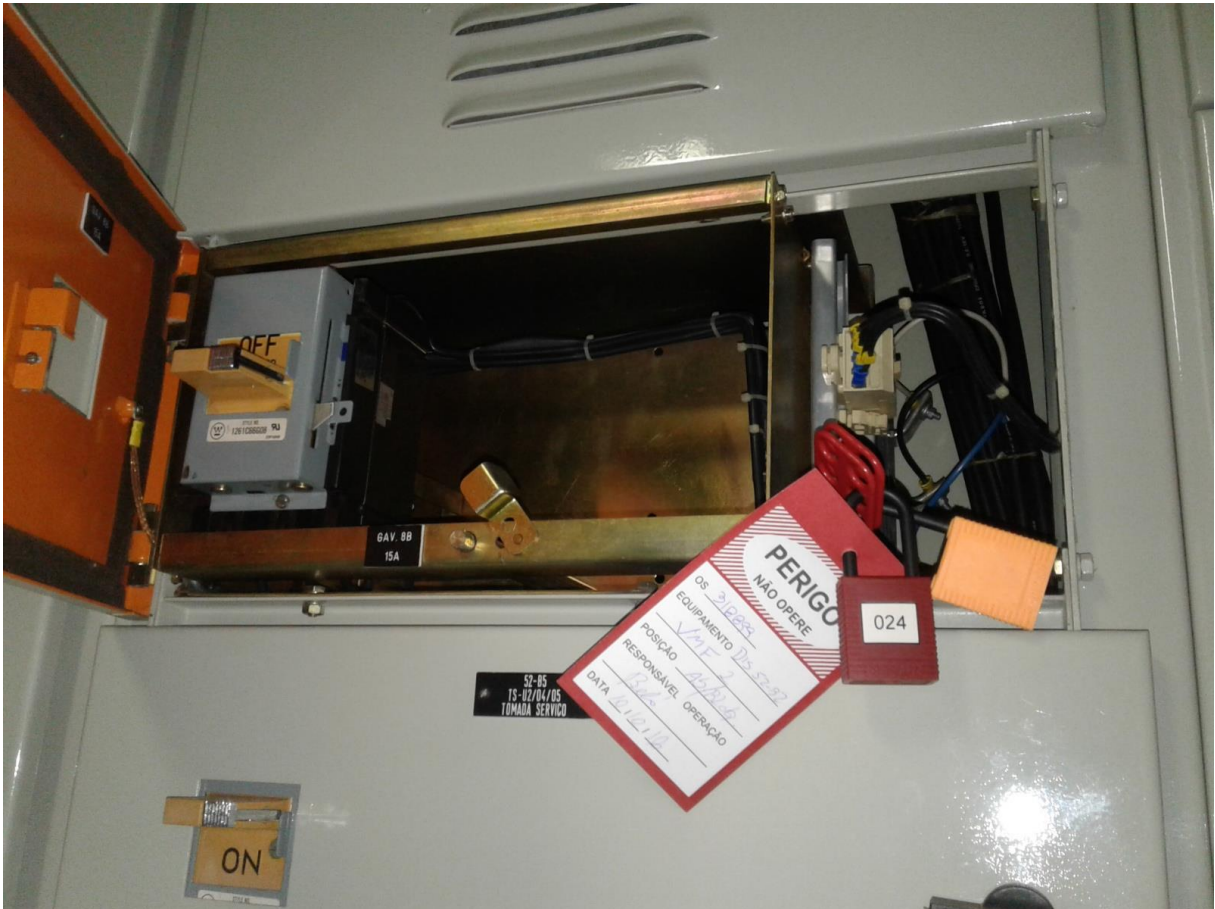
Figura 4: Bloqueio de gaveta do disjuntor
