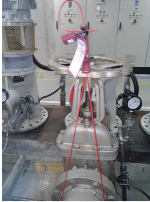
Figura 2: Bloqueio de válvula gaveta Fonte: Autor
