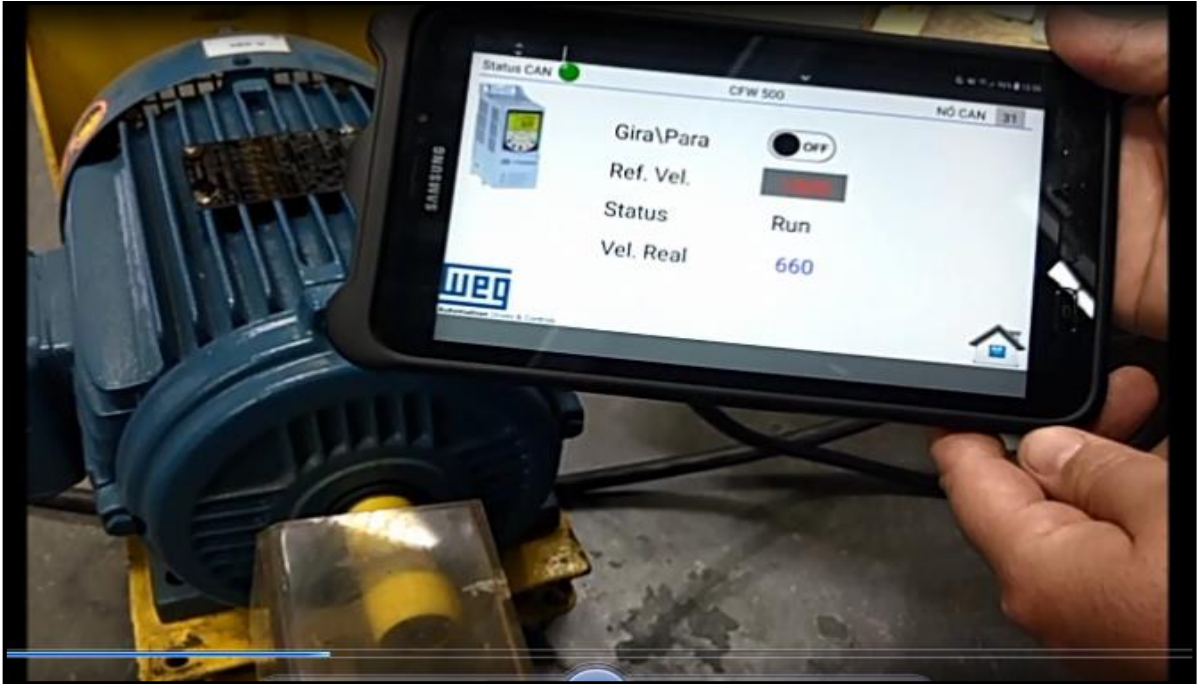
Figura 4 – Motor Acionado por Inversor de Frequência Fonte: Registrada pelo autor (2020)
