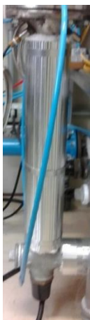
Fotografia 1 – Tubulação com resistor de 2500 W localizado no seu interior e próxima do plenum
