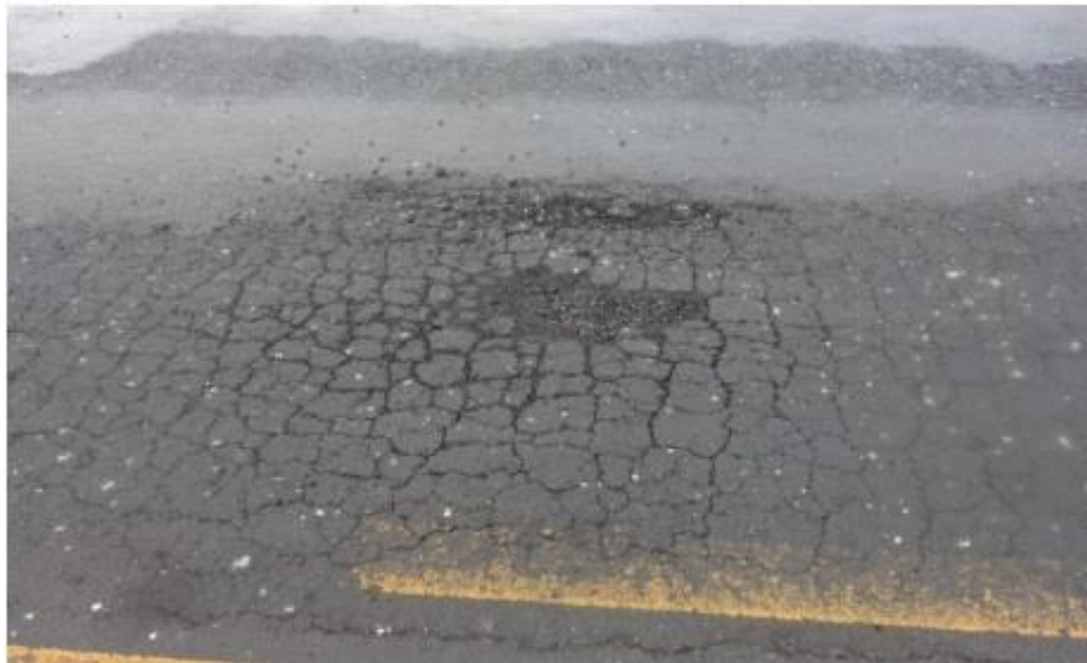
Figura 3 - Trinca couro de jacaré
