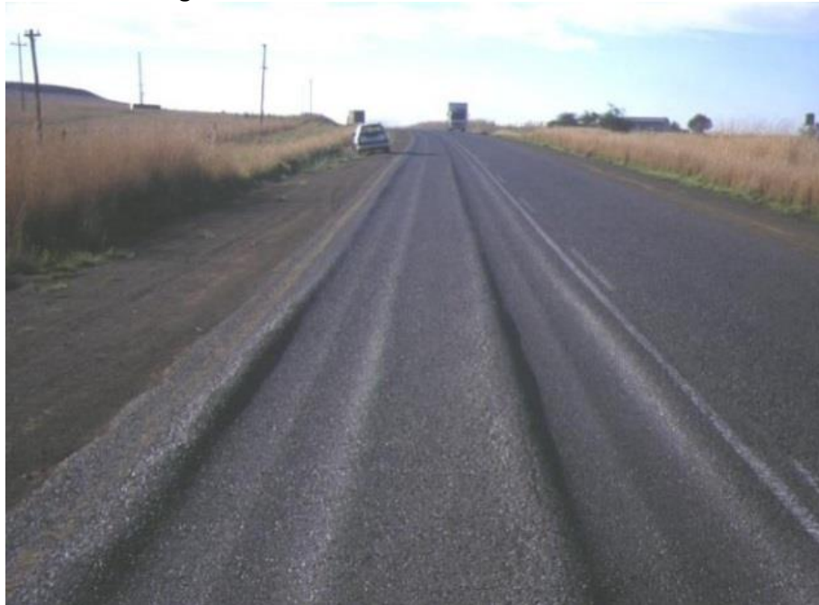
Figura 1 – Fluência do revestimento asfáltico.
