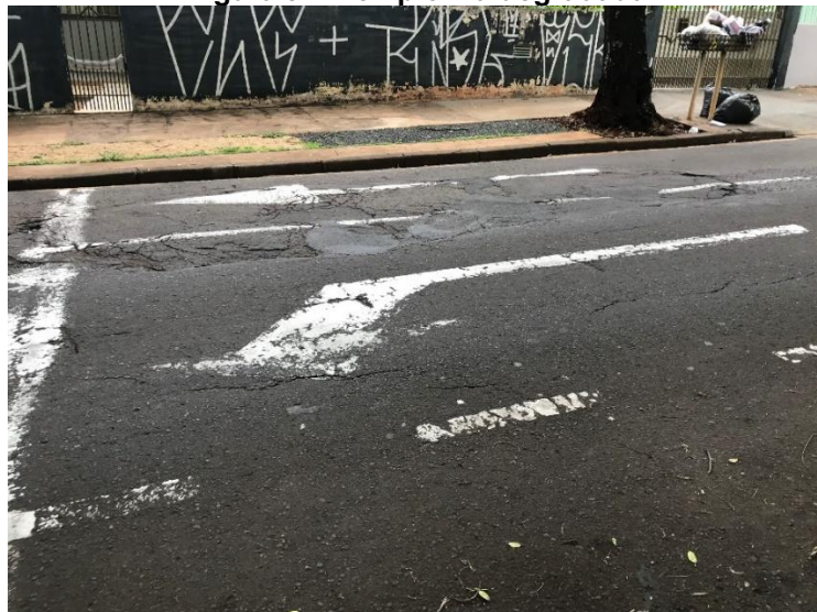
Figura 9- Exemplo via degradada
