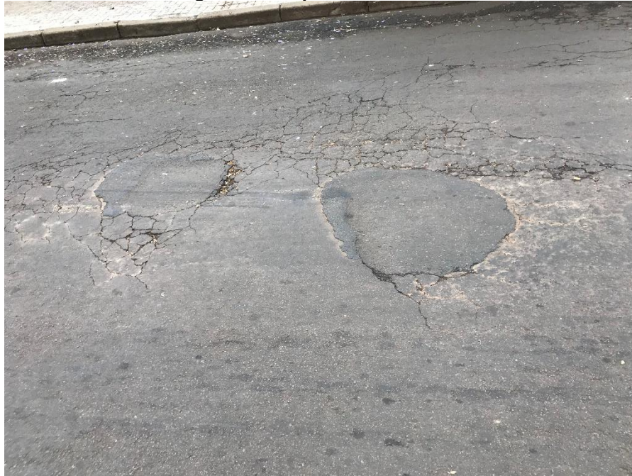
Figura 10 - Reparo mal efetuado
