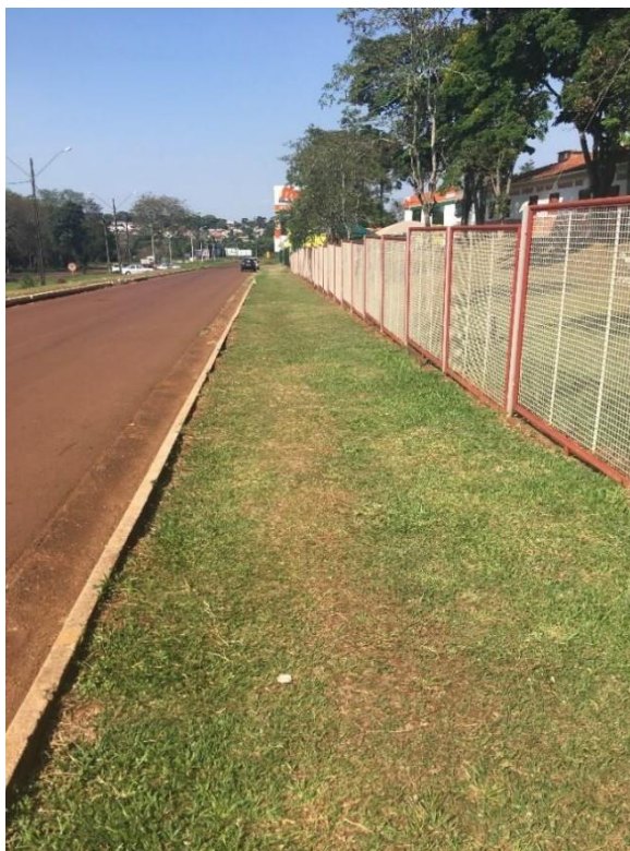
Figura 22. Parte do trecho sem pavimentação na Rua Rosalina Maria Ferreira
