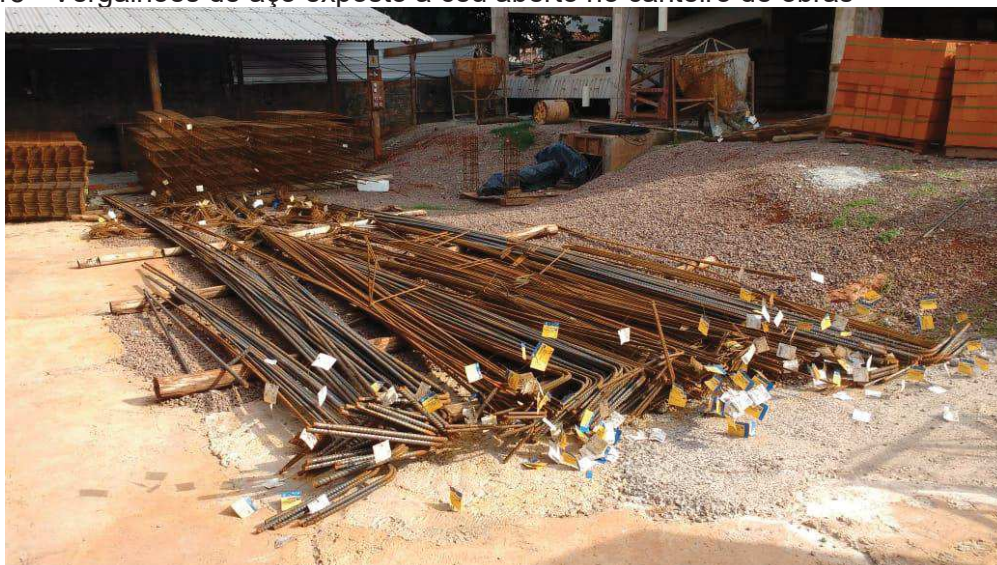
Figura 15 - Vergalhões de aço exposto a céu aberto no canteiro de obras
