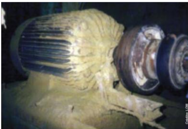
Figura 24: Acumulo de pó em motor elétrico.
