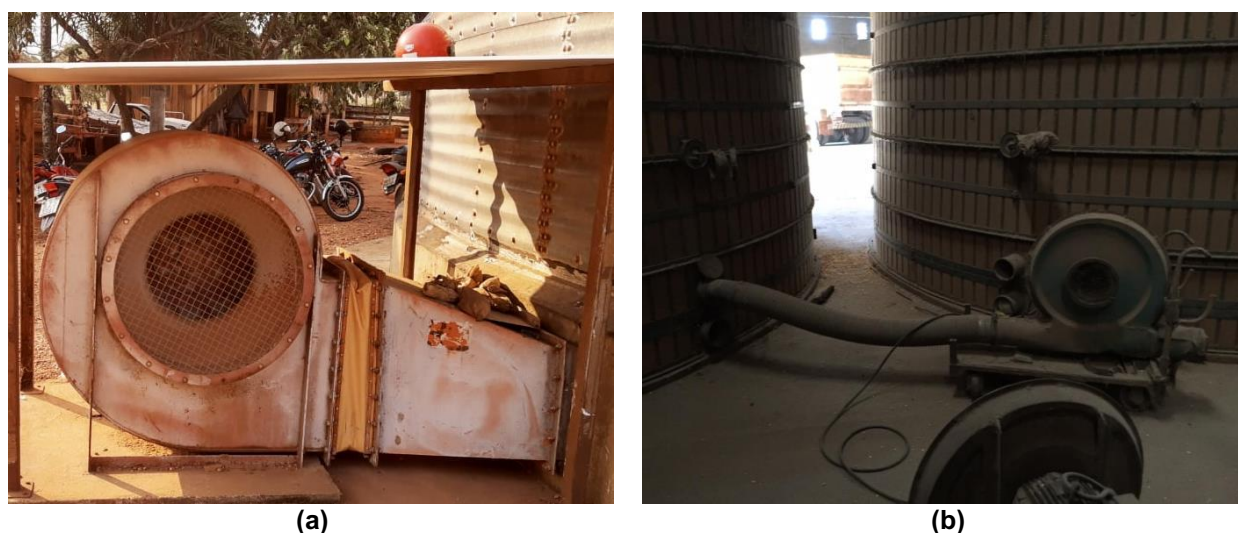
Figura 32: Sistema de movimentação de ar nos silos da unidades A e B.
