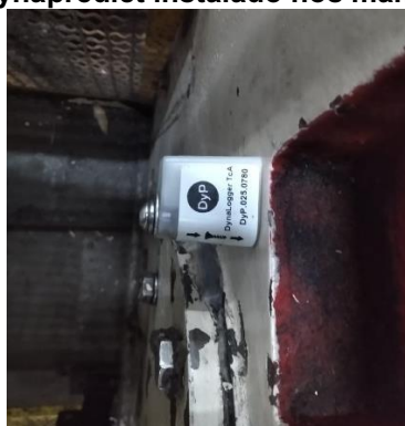
Figura 6 – Sensor dynapredict instalado nos mancais dos rolamentos
